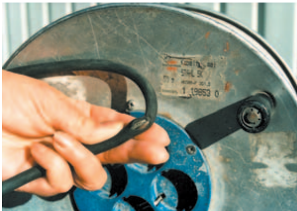
Bild 3-4: Verschlissene und für den Bereich Bau-/Montagestelle ungeeignete leichte Gummischlauchleitung Typ H05RR-F
